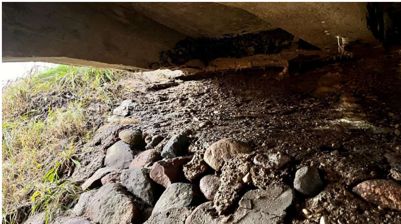
14 pav. Šlaitų sutvirtinimai suirę
