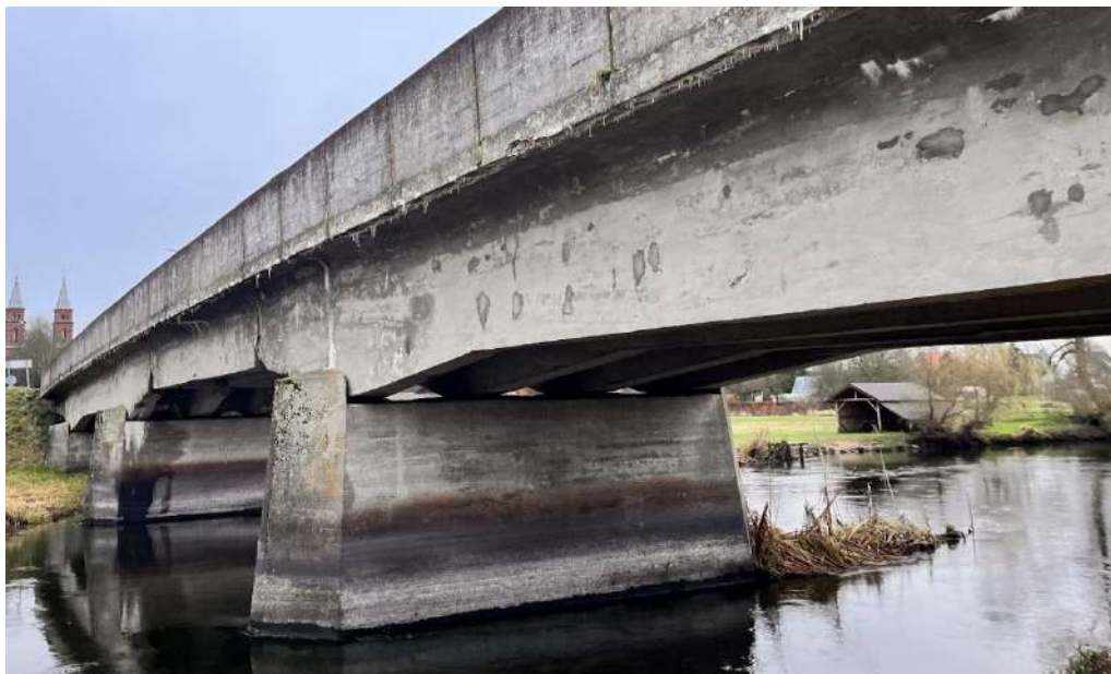
12 pav. Taurų konstrukcijų betonas netankus, porėtas
