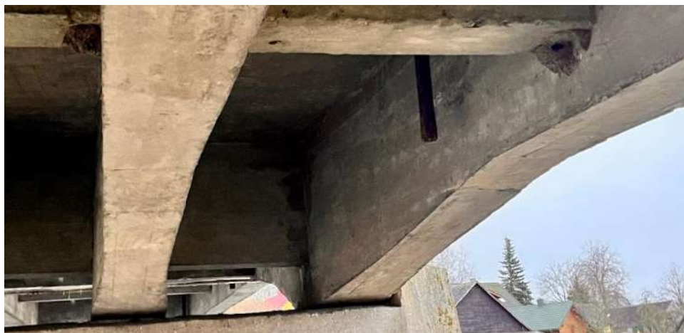
13 pav. Nesandari šulinėlio konstrukcija, surūdijęs šulinėlio konstrukcijos metalas.
