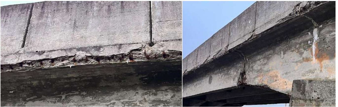
8 pav. Pažeistas apsauginis betono sluoksnis, armatūra koroduoja.
