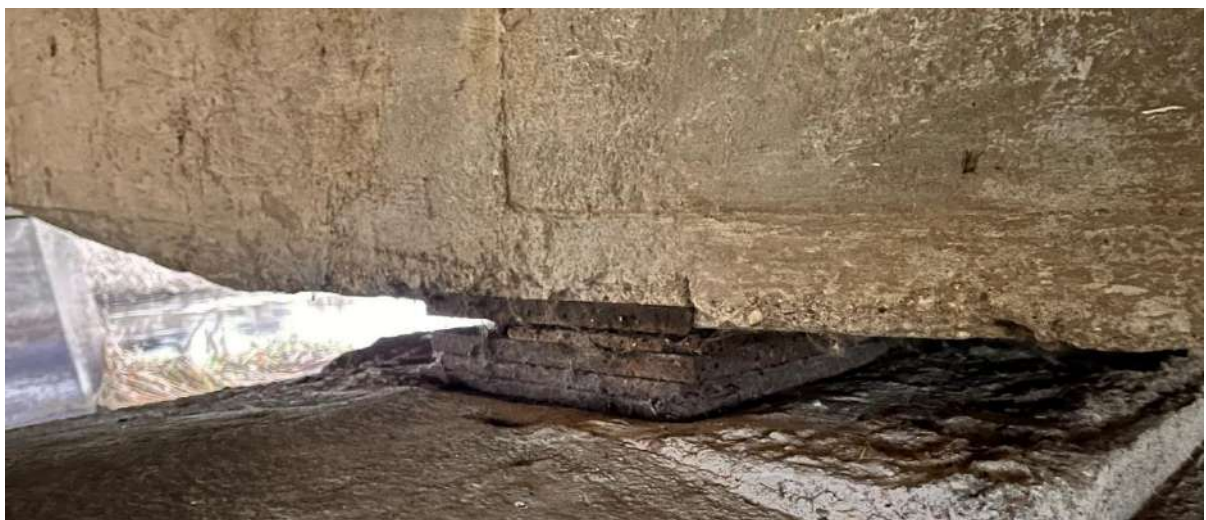
9 pav. Atraminiai guoliai smarkiai paveikti korozijos, metalas išsisluoksniavęs.
